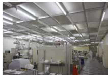
武田先端知ビル(本郷)地下のクリーンルーム
