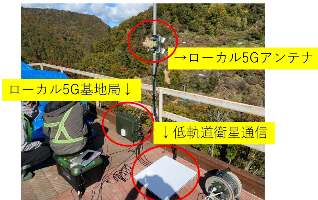
図1：ダム建設現場に設置したローカル 5G・低軌道衛星通信の接続システム
