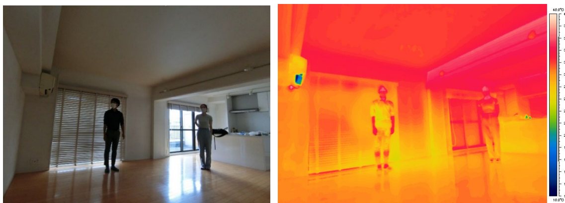
断熱性能・日射遮蔽性能の不足により、住戸内の温度環境が均一でない様子
