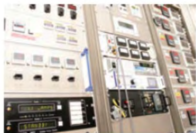
真空装置コントローラー
